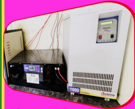
Microtek 11kva UPS 192v 100Ah
